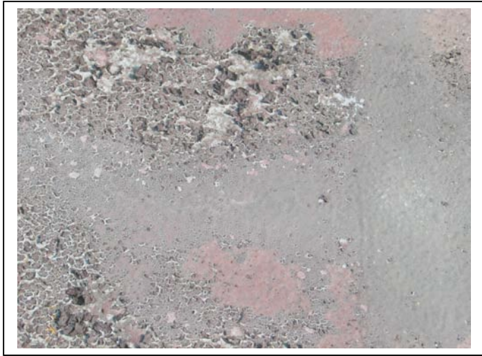
Bild 10: Aufbruch der Oberfläche nach einem Rotalgenbefall
