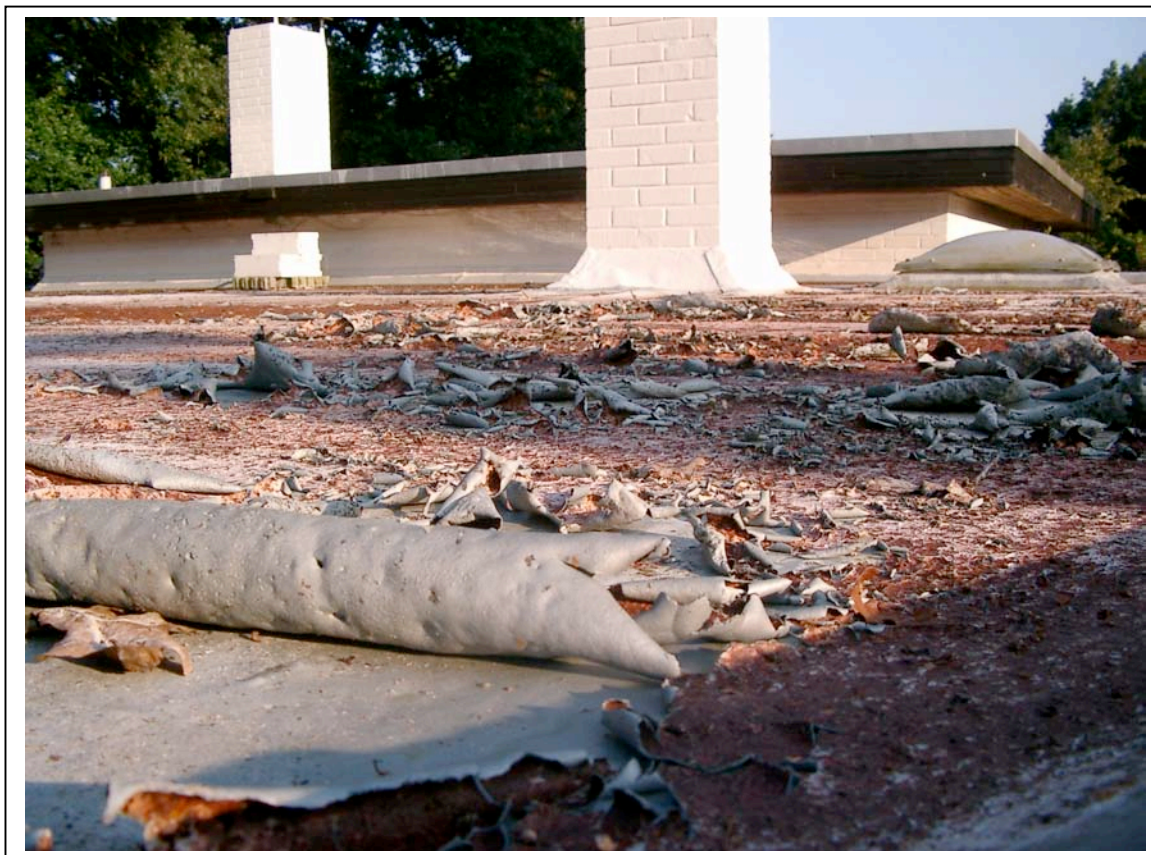
Bild 1: Völlig zerstörte Oberfläche auf einem Flachdach, der Untergrund löst sich und rollt sich stellenweise großflächig auf.
