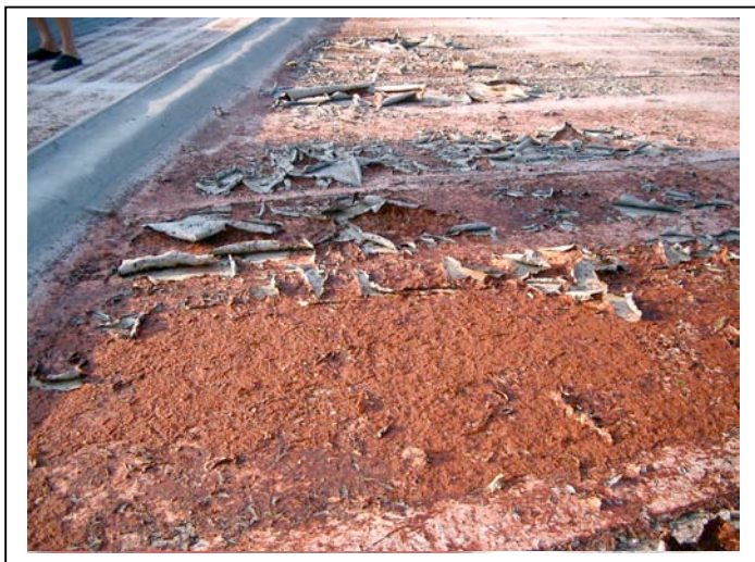
Bild 11: Endstadium: Die betroffene Oberfläche hat vollständig aufgelöst.
