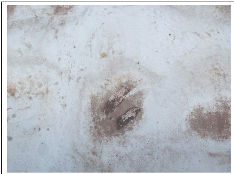
Bild 7: Eine einzelne trockenliegende Pfütze mit erstem Rotalgenbefall
