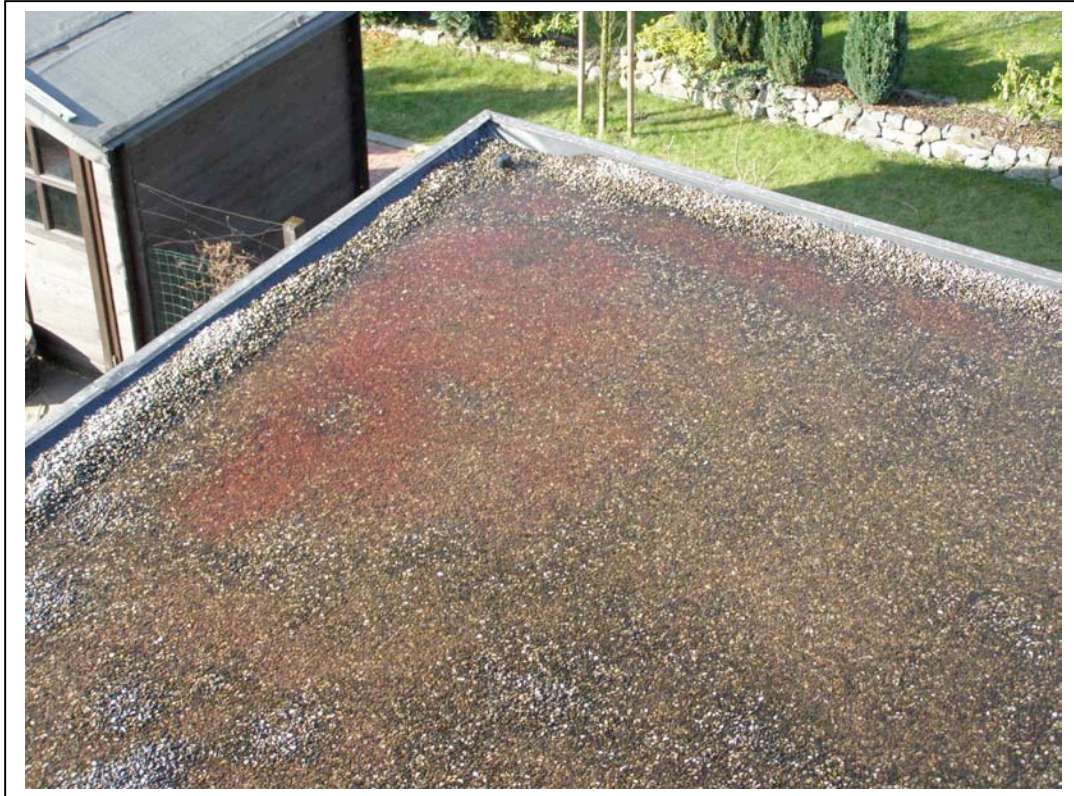
Bild 5: Rotalgenbefall auf einem bekiessten Garagendach
